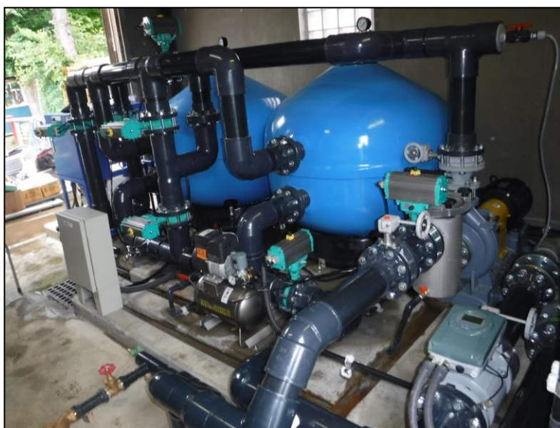
No.5 調布市立緑ヶ丘小学校プール循環浄化装置改修工事 プール循環浄化装置 設置状況
